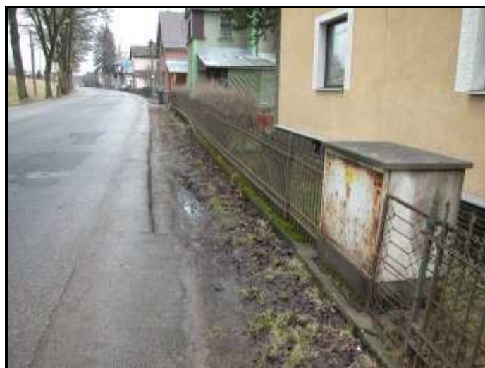
12 – Havarijní stavy podezdívek oplocení
